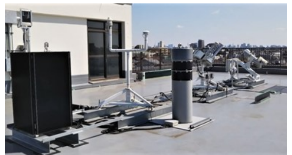
図3 総研屋上に設置した各種気象センサと太陽光発電モジュール
